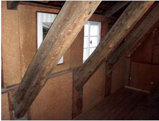
Von Feuchtigkeit aufgequollene Wandverkleidung aus Spanplatten wurden entfernt...
